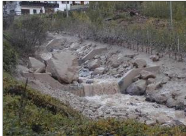
Briglie di consolidamento – River consolidation
