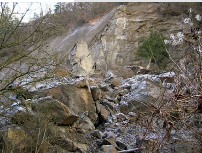
FOTO Il crollo avvenuto in val dei Cagni ha causato l'ostruzione parziale del rio Carera, 11 dicembre 2007.
