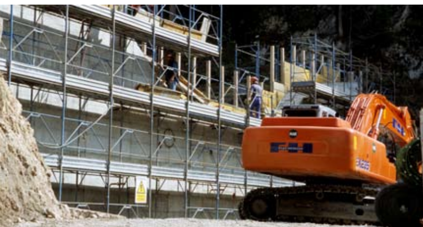
FOTO Cantiere di sistemazione del Rio Val della Vecchia nel bacino del torrente Cisonon.
